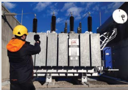
KRAJEVNA NADZORNIŠTVA V ELEKTU GORENJSKA SO OPREMLJENA S TERMOGRAFSKIMI KAMERAMI. Foto: Arhiv Elektra Gorenjska
