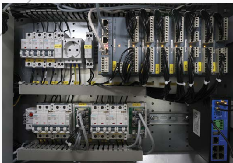
Vgrajene Siemensove naprave RTU A8000 nam omogočajo številne napredne funkcije in inovativne rešitve.
