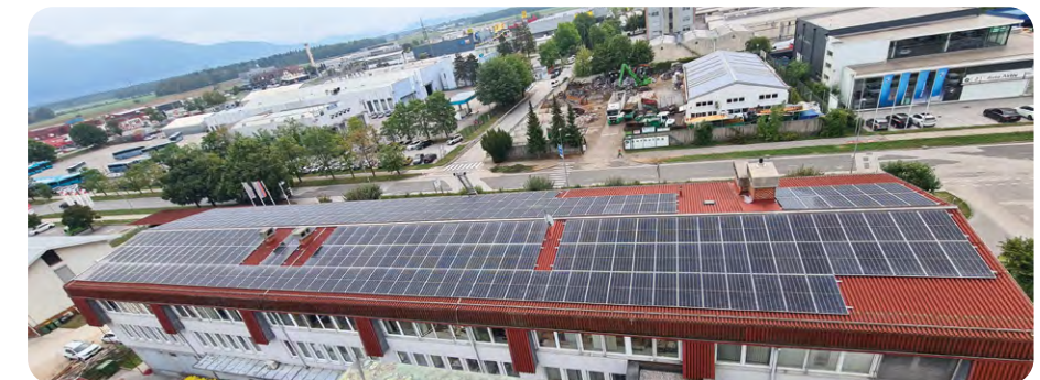
Sončna elektrarna na stari stavbi družbe Elektro Gorenjska Foto: Robert Jošt
