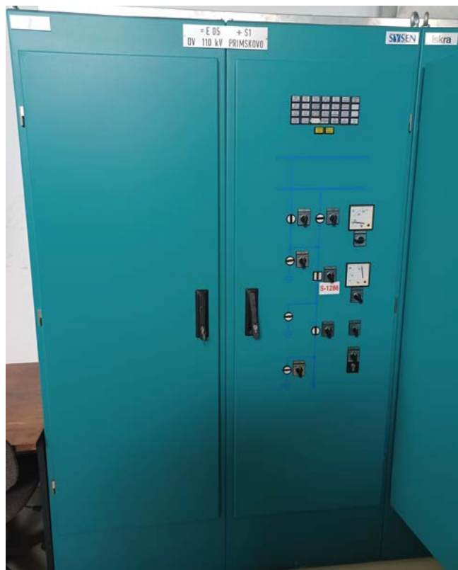
Obstoječa omara vodenja 110 kV DV polja
