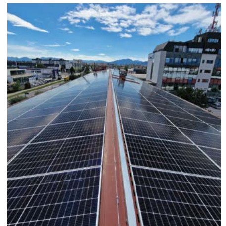
Streha stare upravne stavbe je v celoti pokrita z moduli Foto: Arhiv Elektra Gorenjska
