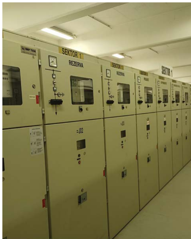
Obstoječe 20 kV stikališče, kjer se bo zamenjala oprema vodenja in zaščite
