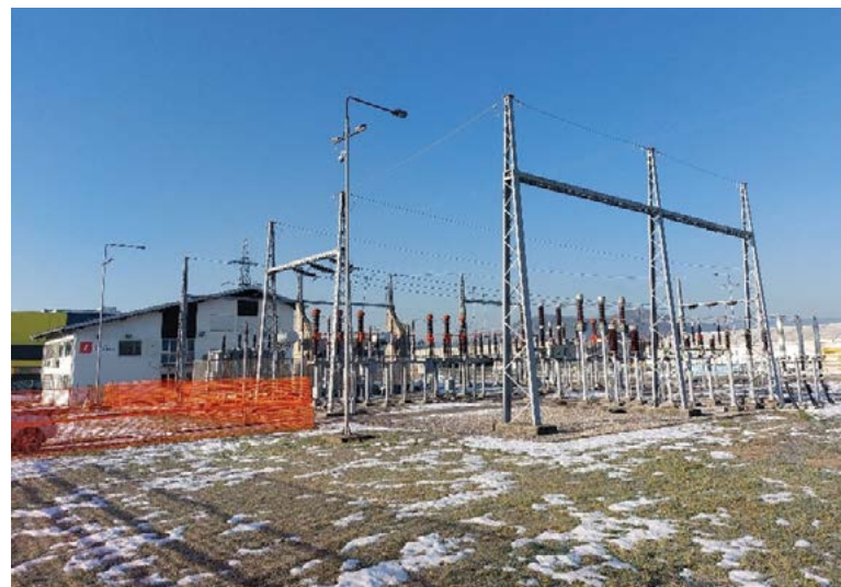
Obstoječe stanje 110 kV stikališča RTP Primskovo
