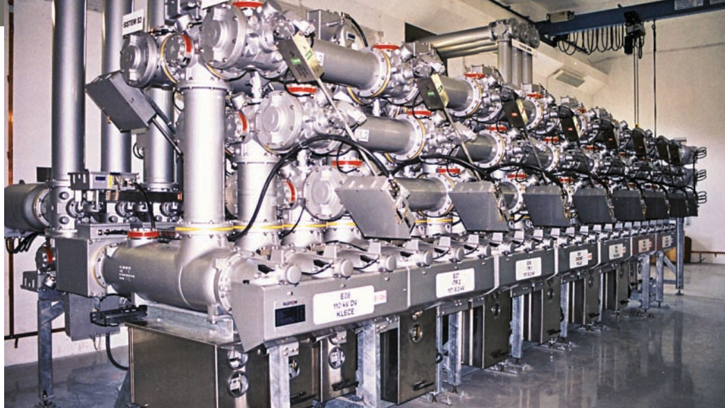
RTP Labore 110/20/10 kV s tehnologijo SF 6 je bilo odprto 21. novembra 2002 (foto Drago Papler)
