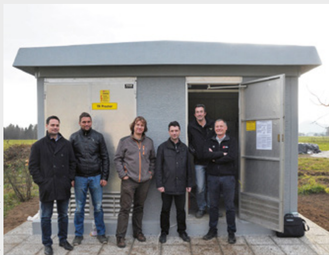
V omrežje TP Suha pri Predosljah je bil vgrajen prvi regulacijski transformator
