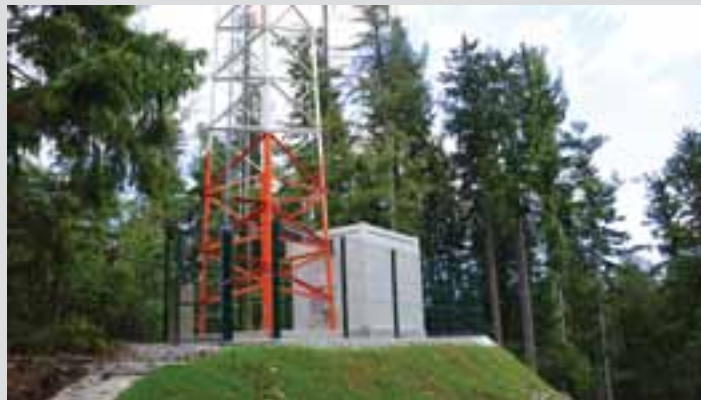
Nov telekomunikacijski objekt na Jezerskem, ☒ Arhiv Elektra Gorenjska
