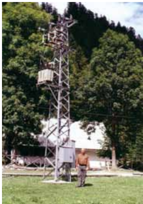
Peter Košir v Medvodjah pri transformatorski postaji Medvodje
