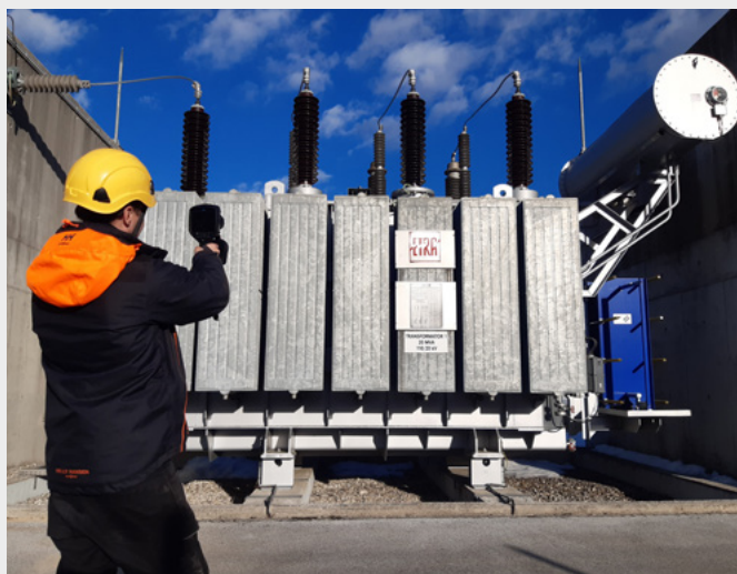
Termografski pregledi elektroenergetske opreme
