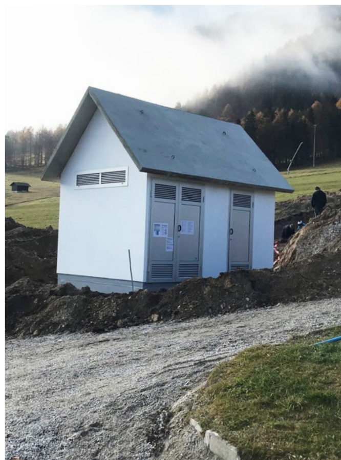
TP Preseka služi za napajanje snežnih topov na smučišču Kranjska Gora
