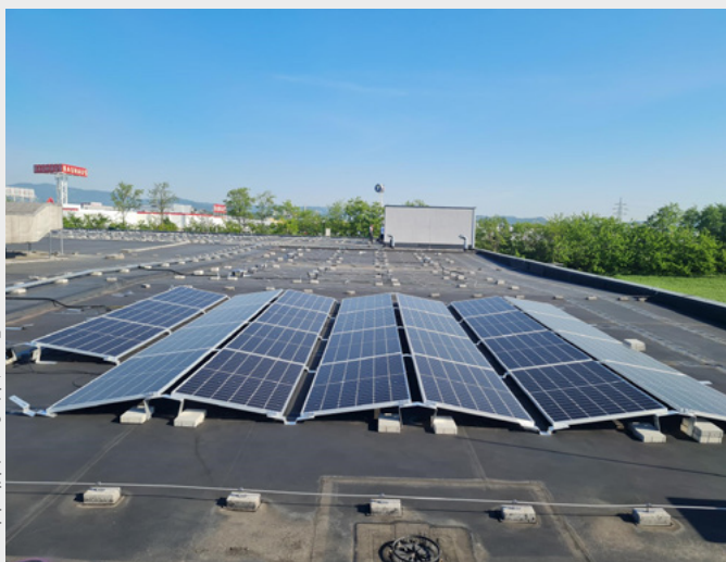
Sončna elektrarna na strehi TC Merkur Maribor
