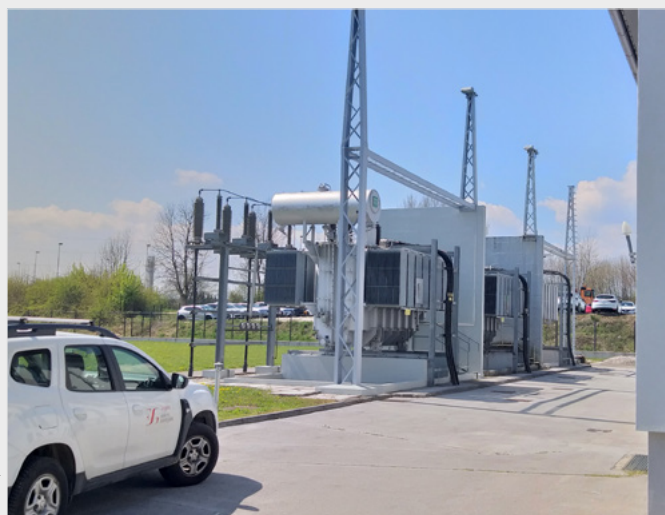
Transformatorji 110/20 kV RTP Labore
