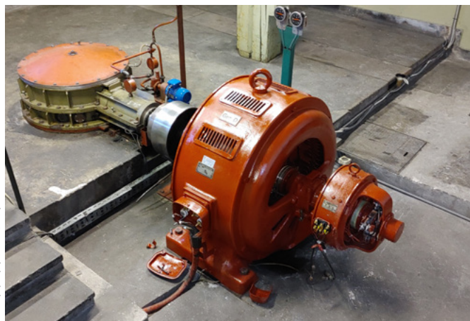
Okvarjen generator agregata D v hidroelektrarni Sava
