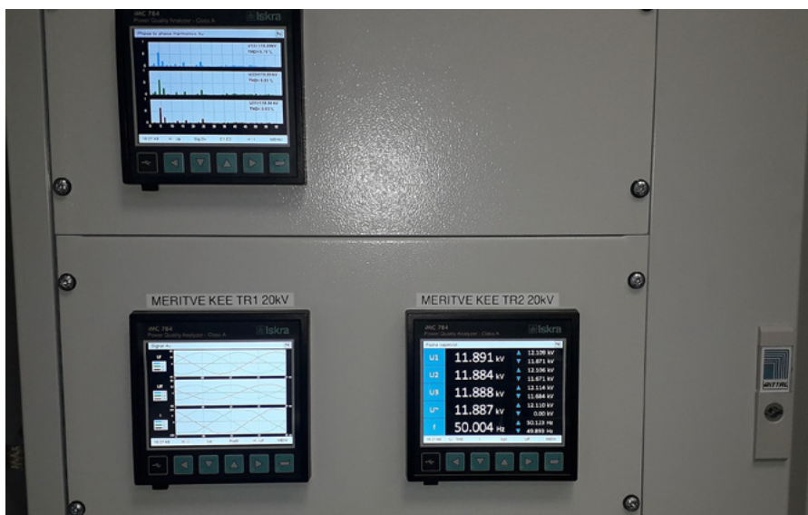
Nameščeni merilniki iMC784 v razdelilni transformatorski postaji Zlato Polje
