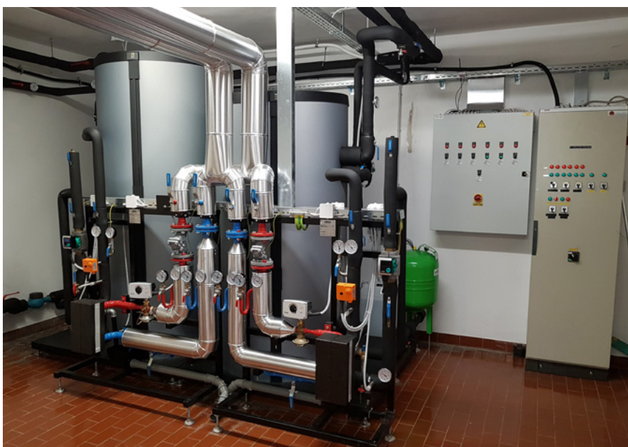
Nova podpostaja v VVZ Najdihojca za potrebe ogrevanja in pripravo tople sanitarne vode (TSV) v dveh ločenih bojlernih
