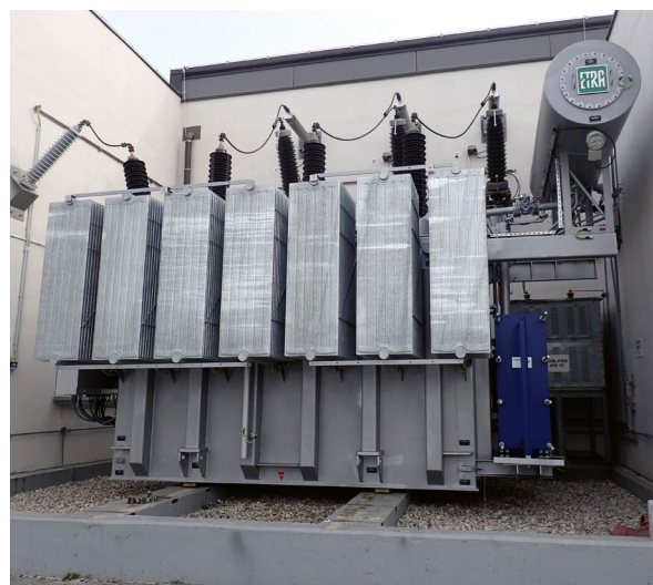
Nov močnostni transformator 110/20 kV 31,5 MVA s toplotnim izmenjevalcem
