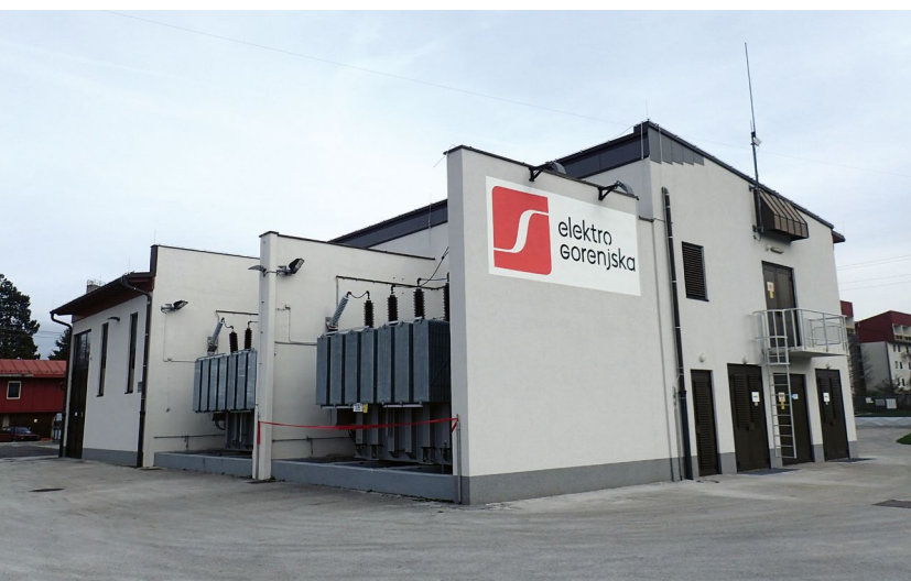
RTP 110/20 kV Zlato polje z novim močnostnim transformatorjem moči 31,5 MVA
