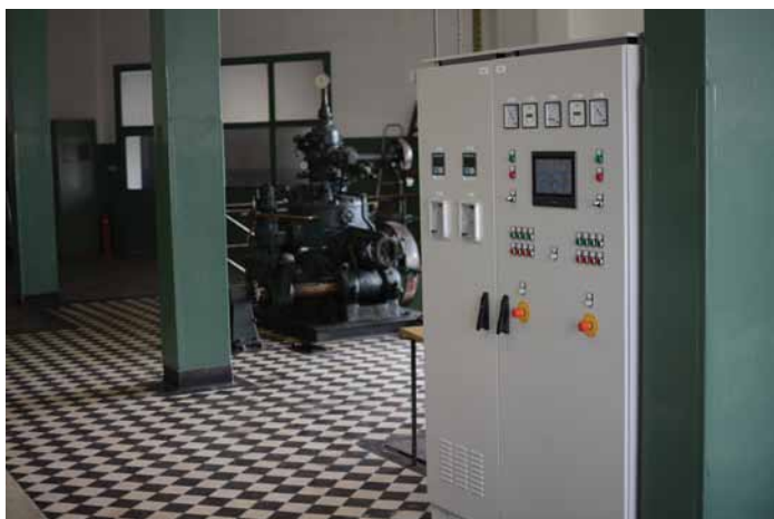
Gorenjske elektrarne v svojih elektroenergetskih objektih pristopijo k implementaciji centralnega nadzora in daljinskega krmiljenja ter k polni avtomatizaciji hidroelektrarn. Na fotografiji je nova omara vodenja v HE Sava, Jan Urbanc
