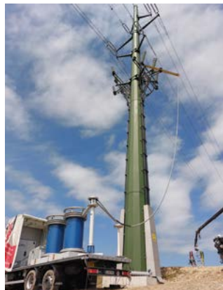
DVA DVOSISTEMSKA KOMPAKTI RNA STEBRA ZAKLJUČUJETA KABELSKO POVEZAVE NA DALJNOVODU OKROGLO/KLEČE IN ŽELEZNIKI
