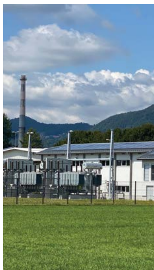
NAŠA NAJVEČJA RAZDELILNA TRANSFORMATORSKA POSTAJA
