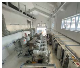
NOVO GIS-STIKALIŠČE TER OMARE VODENJA IN ZAŠČITE
