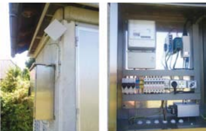
Slika 4: TP Črnivec Spodnja opremljena s komunikacijo WiMAX in AMI-koncentratorjem
