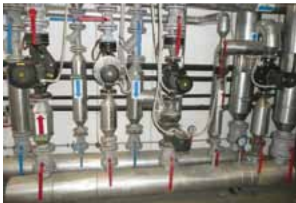
Črpalke za transport tople vode po objektu
