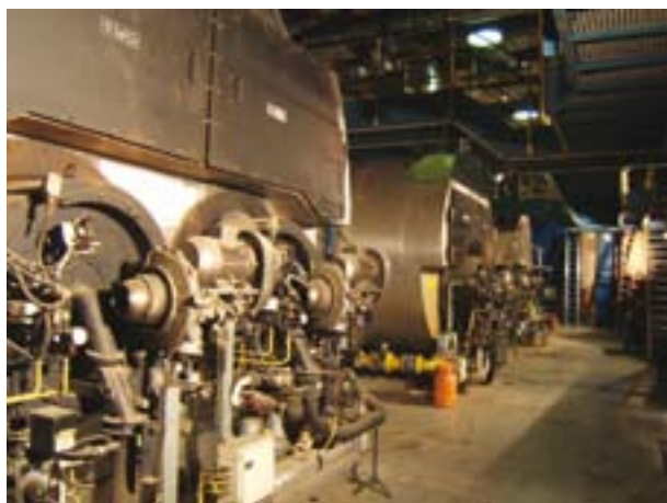
Vročevodni plinski kotli nazivne moči 18,5 MW, 17,4 MW in 9,2 MW pred zamenjavo
