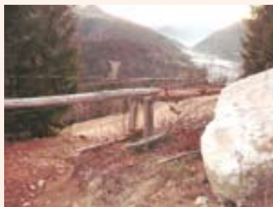
Drevesa so podrla nosilne droge 20 kV daljnovoda Podlonk
