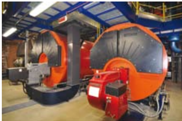
Nova vročevodna plinska kotla nazivne moči 7 MW in 10 MW
