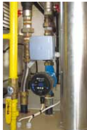
Nova črpalka na Kogeneraciji Elektra Gorenjska
