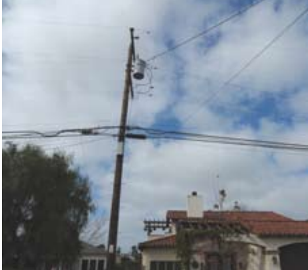
Enofazni energetski transformator
