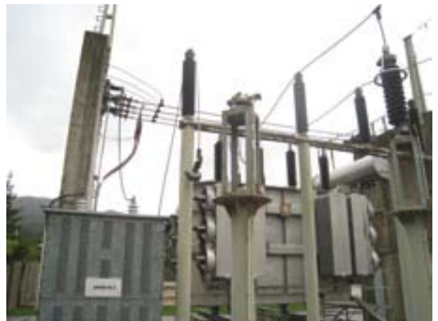
Poškodovan prenapetostni odvodnik v RTP Tržič ob razpadu elektroenergetskega sistema na Gorenjskem, Bojan Brezničar
