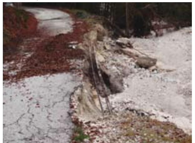
Poškodbe kabelskega omrežja, ki ga je povzročil potok Triglavsko Bistrica, 📷 Janez Vidic
