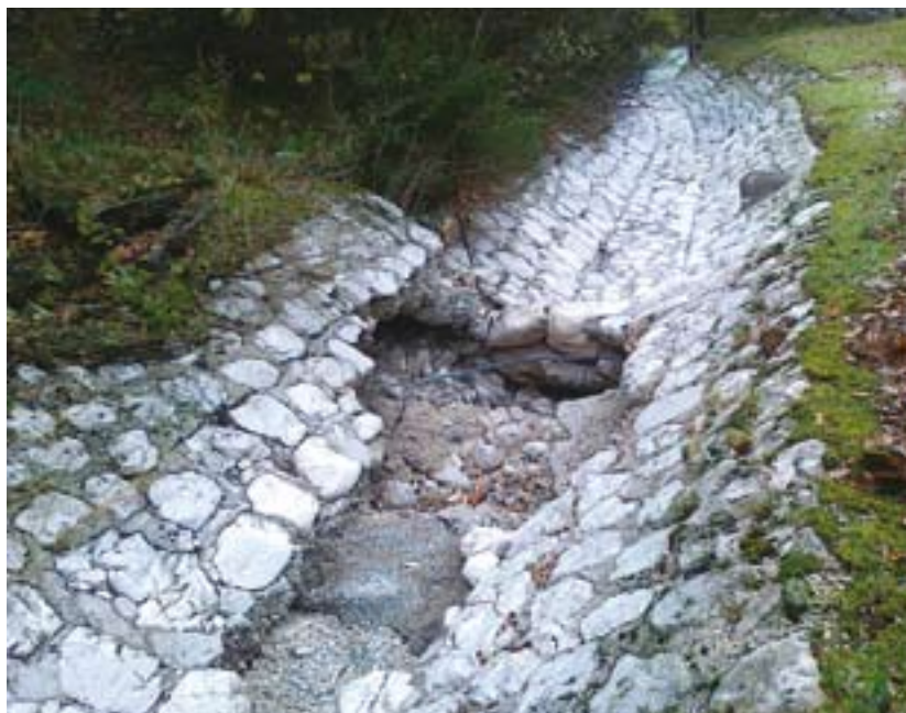
HE Savica – poškodovan kanal za odvodnjavanje, Alojz Markelj
