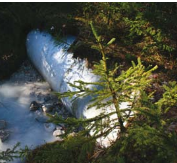
Poškodbe na HE Mojstrana – voda je odnesla brežino, kjer je vkopan cevovod, Robert Grašič
