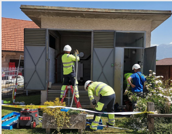
Praktična vaja je potekala v transformatorski postaji Senčur
