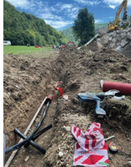
POŠKODOVANO OMREŽJE V HRASTNICI FOTO: ARHIV ELEKTRA GORENJSKA
