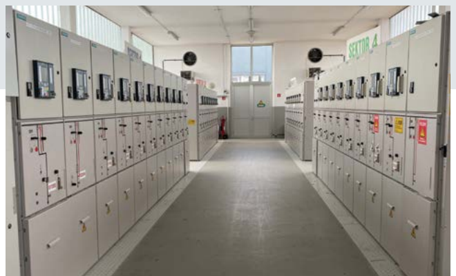
20-KILOVOLTNO STIKALIŠČE Z NOVO SEKUNDARNO OPREMO NA 41 STIKALNIH CELICAH
