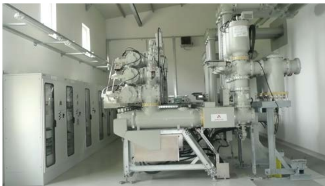
RTP ŽELEZNIKI Foto: Arhiv Elektra Gorenjska
