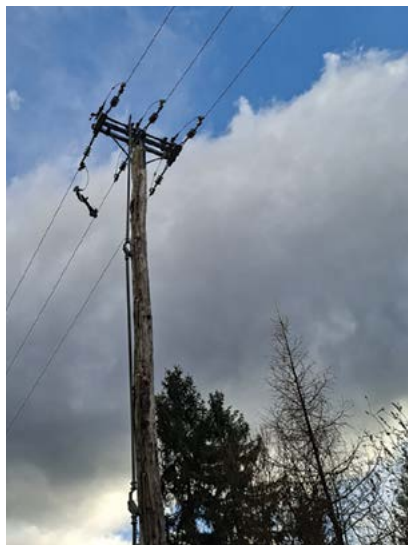
V GORJAH JE DREVO POŠKODOVALO DALJNOVOD Foto: Arhiv Elektra Gorenjska
