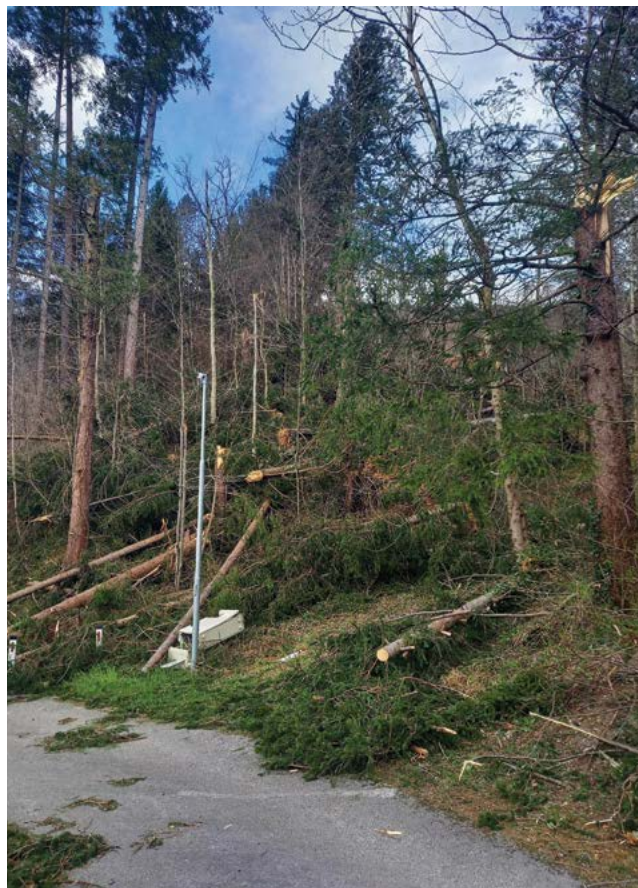
POŠKODOVANA TRASA 20 KV DALJNOVODA HUDO-MLAKA
