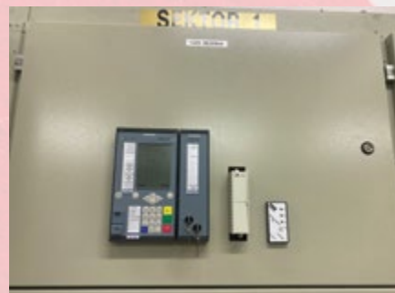
VIDEZ STARE IN NOVE SEKUNDARNE OPREME V 20 KV STIKALIŠČU
