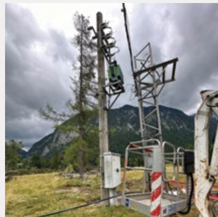
JULJSKI VETROLOM V DOLINI RADOVNE JE MOČNO POŠKODOVAL NAŠE ELEKTROENERGETSKO OMREŽJE
