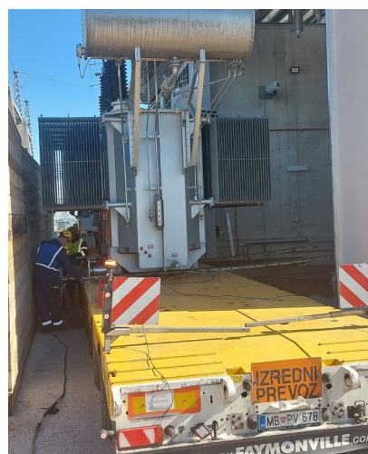
PREMIK ENERGETSKEGA TRANSFORMATORJA
