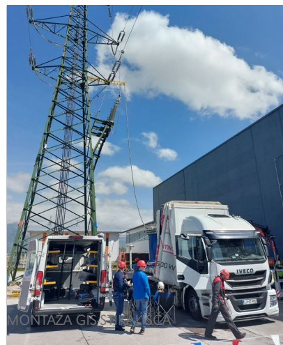
VISOKONAPETOSTNI TEST 110 kV KABLA
