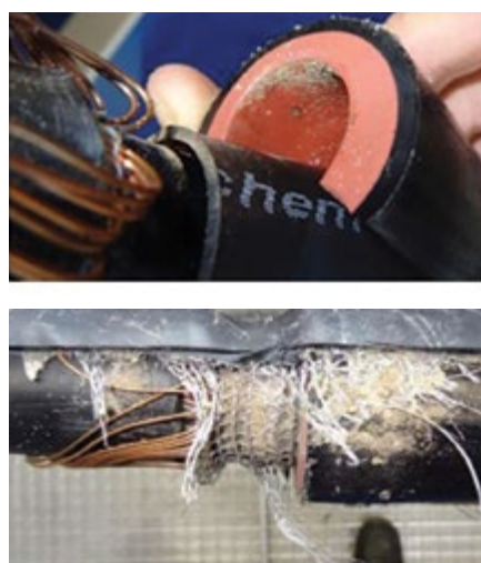
SLIKA 4: PRIMERI SLABE MONTAŽE
