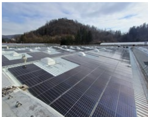
SONČNA ELEKTRARNA Z MOČJO 200,25 KWP JE POSTAVLJENA NA ŠPORTNI DVORANI V SKLOPU OŠ PREDDVOR Foto: arhiv Elektra Gorenjska
