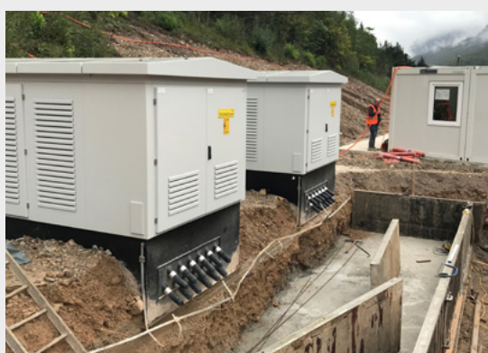
Nadomestni transformatorski postaji
