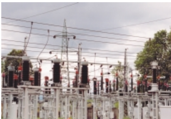
1982 RTP Škofja Loka 110/20/10 kV – Foto: Drago Papler
