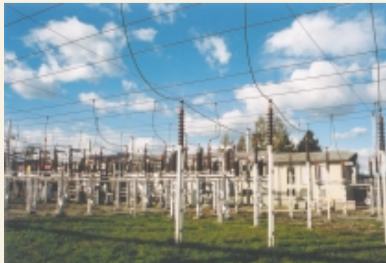
Stikališče RTP Labore 110/10 kV – Foto: Drago Papler
