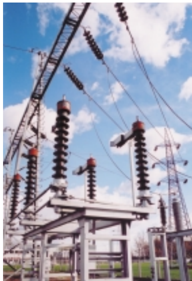
1973 RTP Labore 110/10 kV, prvi 110 kV objekt gorenjske elektrodistribucije – Foto: Drago Papler
