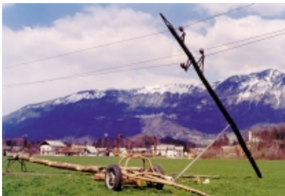
1995 Vetrovni sunki so močno poškodovali drogove 20 kV daljnovoda RTP Zlato polje – Tenetiše – Foto: Drago Papler
