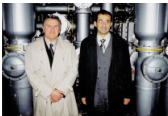
2002 RTP Labore 110/20/10 kV s tehnologijo SF 6 je odprl minister za okolje, prostor in energetiko mag. Janez Kopač (desno) 21. novembra 2002 – Foto: Drago Papler
