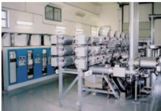
Tretje kovinsko oklopljeno s plinom SF 6 izolirano 110 kV stikališče GIS je bilo montirano v RTP Medvode – Foto: Drago Papler
