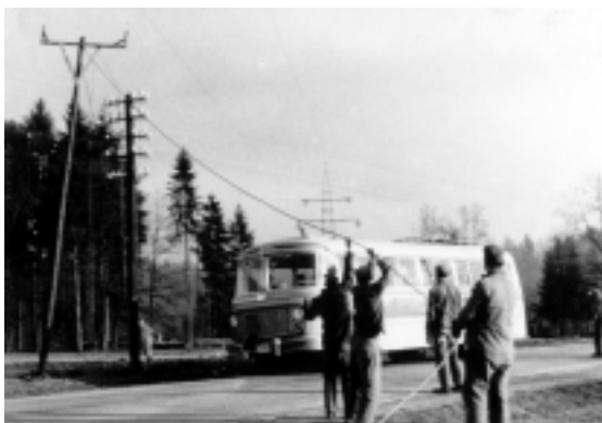
1955 Križanje visokonapetostnih vodnikov daljnovođa preko ceste – Arhiv: Drago Papler
