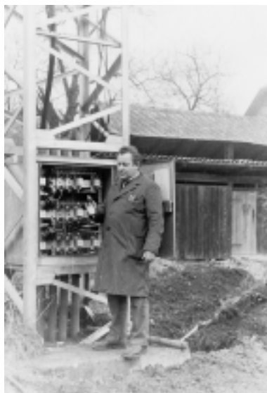
1983 Krajevni nadzornik Podbrezjij Jože Papler ob odklopu nizkonapetostnih odcepih v jamborski transformatorski postaji Posavec – Foto: Drago Papler
