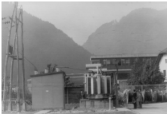
1993 RTP Železniki 35/20 kV – Foto: Drago Papler
