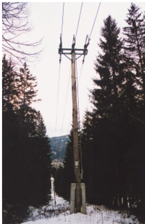
Ekološki daljnovod na Jezerskem s polizoliranimi PAS vodniki omogoča manjše posege v okolje – Foto: Drago Papler
