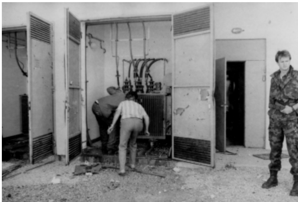
Poškodovana transformatorska postaja RTV Krvavec po letalskem napadu 2. julija 1991 – Slika: Fototeka Gorenjskega muzeja Kranj
