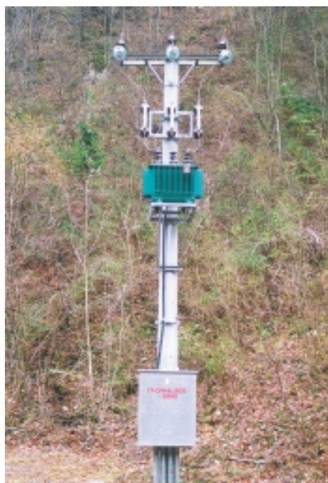
Na občutljivem vodovarstvenem območju smo vgradili v TP Črpališče Grad okolju prijazen transformator 20/0,4 kV, polnjen s hitro razgradljivo tekočino Midel 7131 – Foto: Drago Papler
