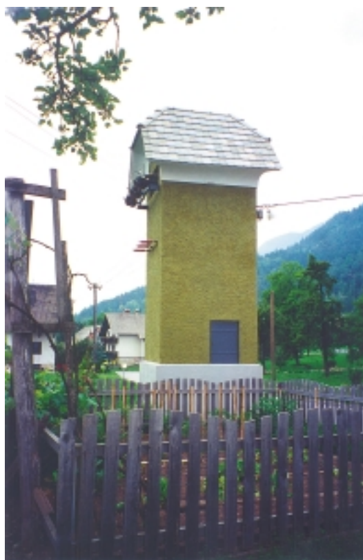
Skrbno vzdrževana stolpasta transformatorska postaja v Poljčah, dediščina Kranjskih deželnih elektrarn – Foto: Tomaž Jamnik
