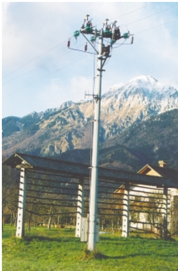
Daljinsko vodeno progovno ločilno stikalo DKS v Tupaličah omogoča občutno skrajšanje trajanja breznapetostnega stanja ob napakah v omrežju – Foto: Drago Papler
