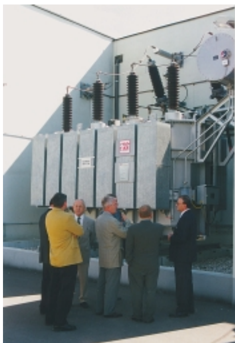
V RTP Zlato polje 110/20 kV sta bila vgrajena ekološka transformatorja moči 2 \times 20 MVA z naravnim hlajenjem in ne povzročata dodatnega hrupa – Foto: Drago Papler
