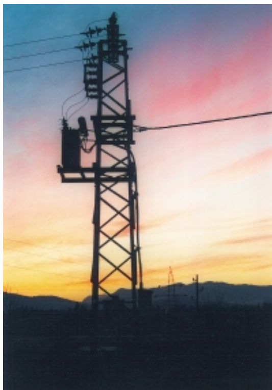
Transformatorska postaja Polica 20/0,4 kV v večerni zarji, april 2000 – Foto: Drago Papler
