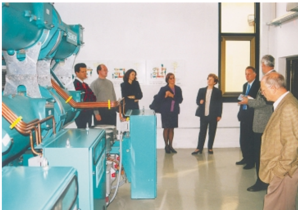
RTP 110/20 kV Zlato polje s kovinsko oklopljenim in s plinom SF 6 izoliranim postrojem GIS pomeni novo tehnološko prelomnico v gorenjski in slovenski distribuciji – Foto: Drago Papler
