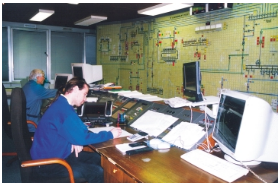
Dežurna energetika v distribucijskem centru vodenja na Zlatem polju bdita dan in noč nad elektroenergetskimi napravami Elektra Gorenjska – Foto: Drago Papler
