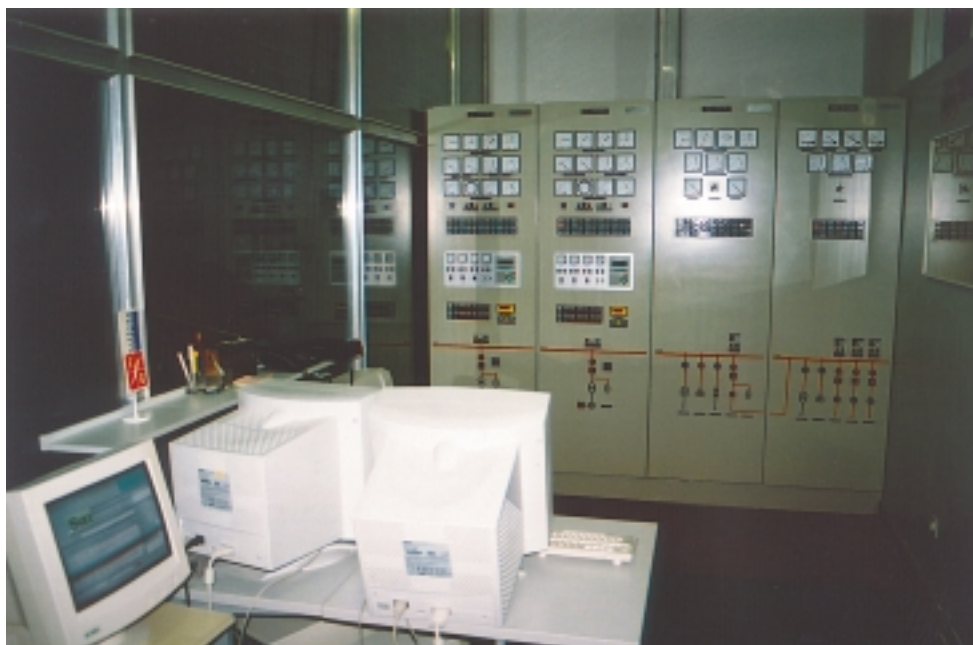
Komandni prostor v HE Savica z računalnikom elektrarne, ki omogoča daljinski nadzor nad njenim delovanjem – Foto: Drago Papler
