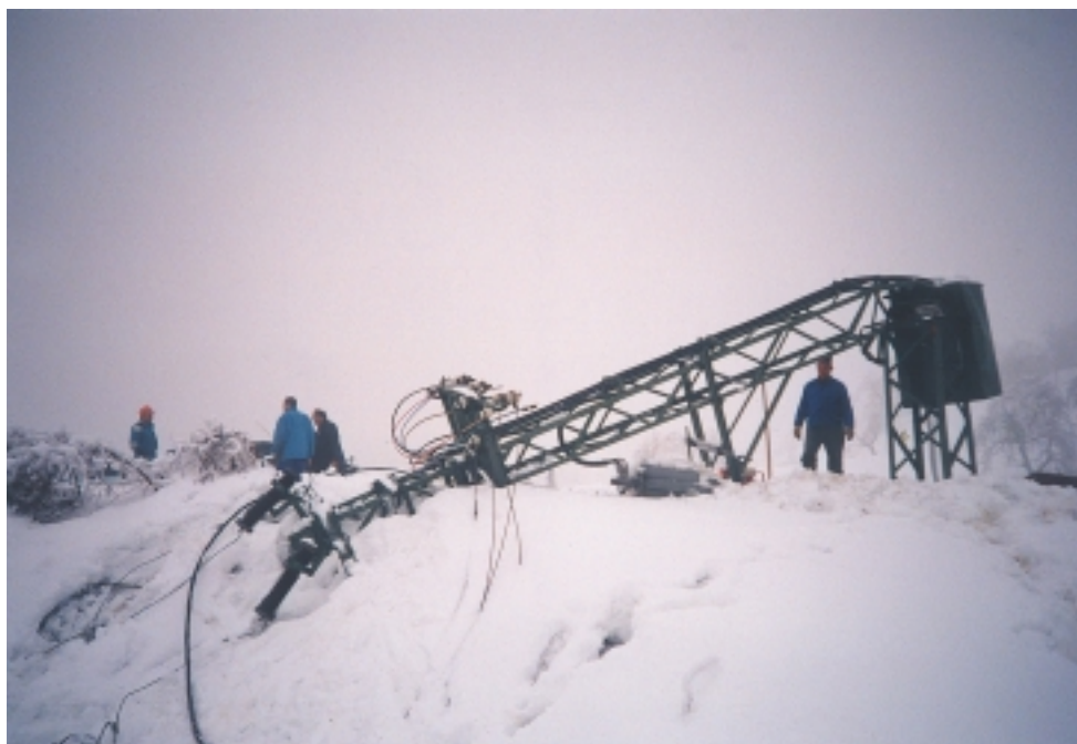
Zaradi žledu porušena jamborska transformatorska postaja Kovski vrh – Foto: Drago Papler
