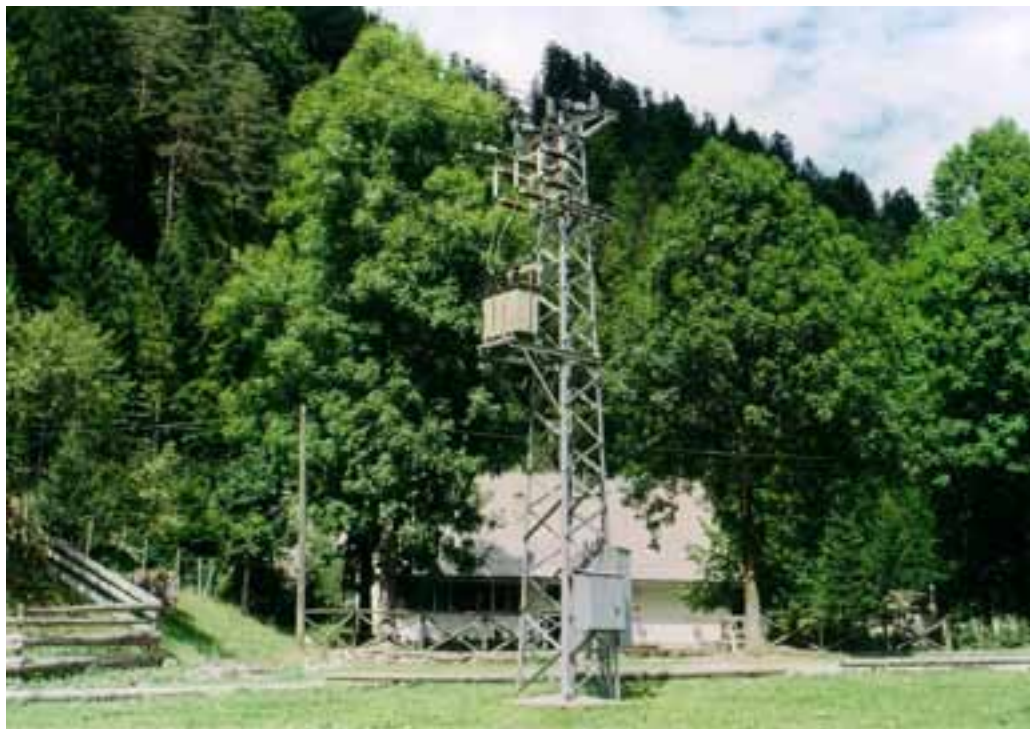
Slika 51: Transformatorska postaja Medvodje
