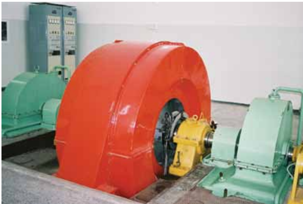
Slika 11: Generator hidroelektrarne Savica Vir: Fotografija dr. Draga Paplerja
