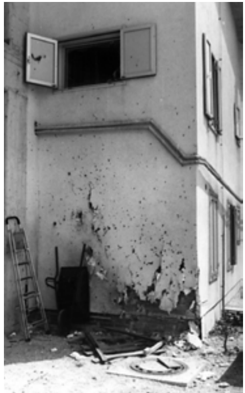
Slika 101: Ostanki streljanja na fasadi objekta Vir: Arhiv dr. Draga Paplerja
