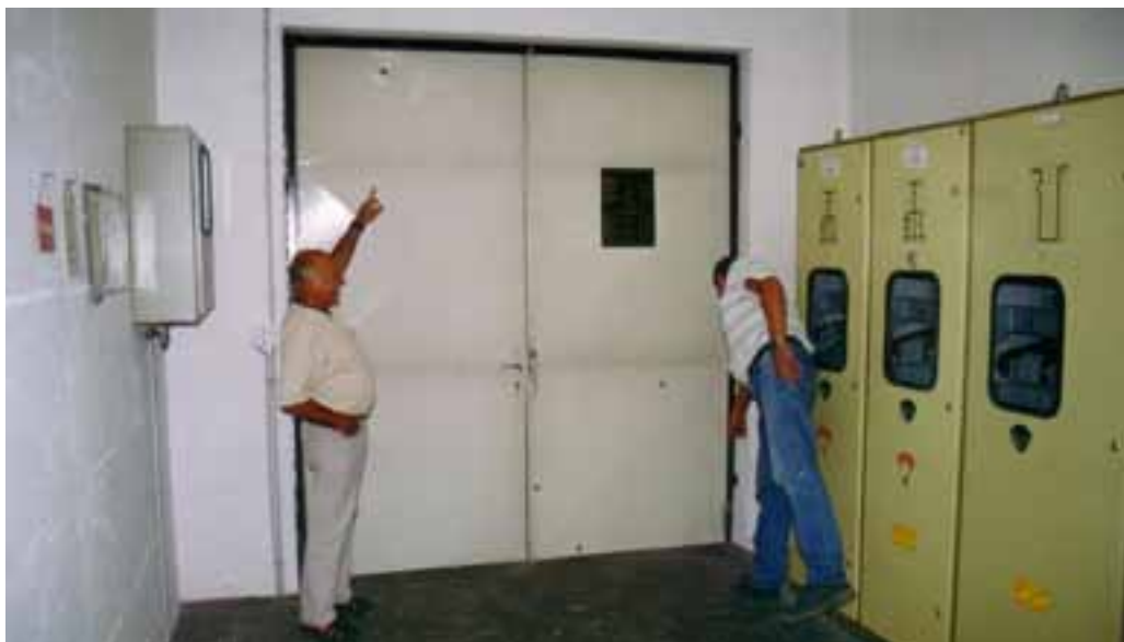
Slika 18: Notranjost transformatorske postaje na karavanškem platoju Vir: Fotografija dr. Draga Paplerja
