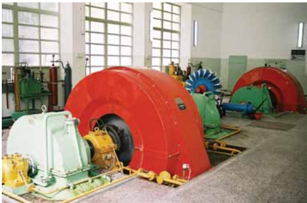
Slika 10: Strojnica hidroelektrarne Savica, Ukanc 140
