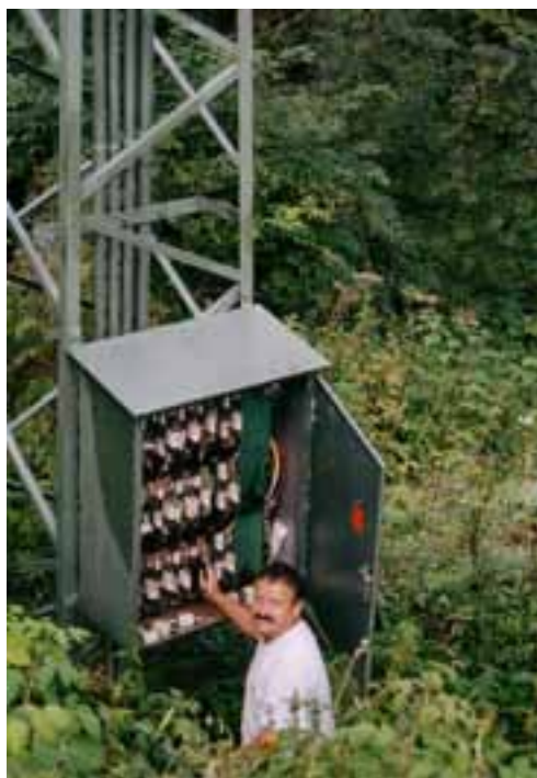
Slika 40: Izklapljanje napetosti v omarici transformatorske postaje Jezerski vrh je nevarno Vir: Fotografija dr. Draga Paplerja
