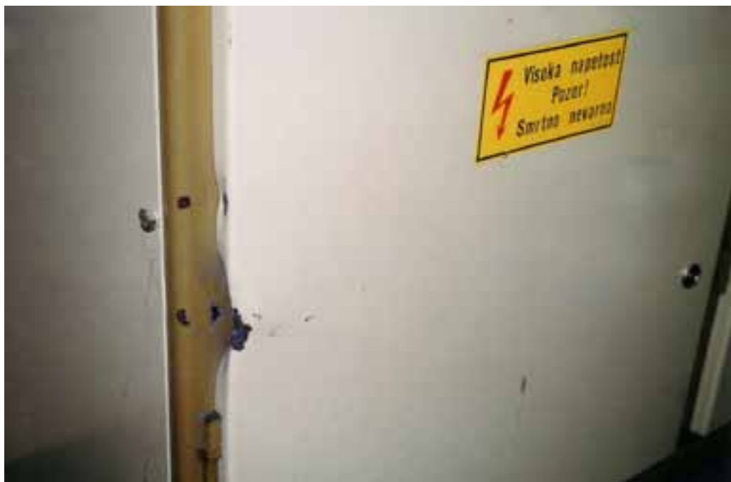
Slika 91: Poškodbe na notranji strani vrat transformatorske postaje na karavanškem platoju Vir: Fotografija dr. Draga Paplerja
