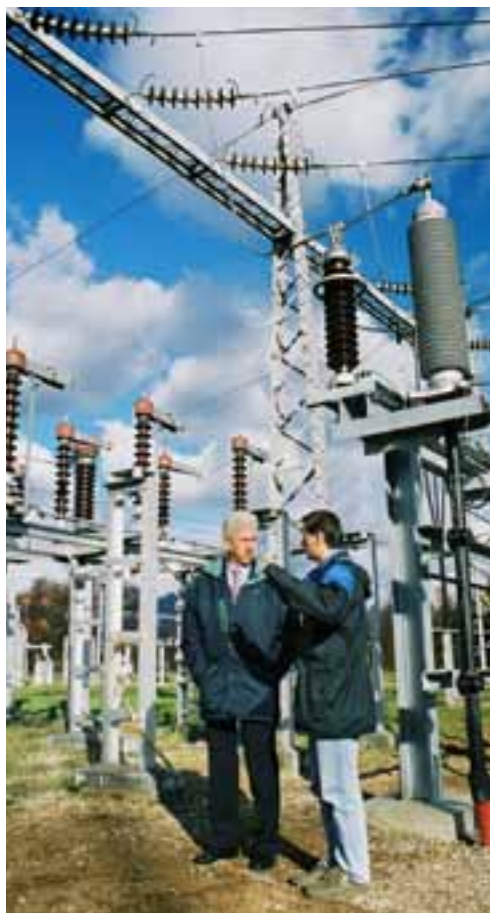
Slika 31: Mag. Matija Nadižar in Gregor Štern v razdelilni transformatorski postaji Labore Vir: Fotografija dr. Draga Paplerja
