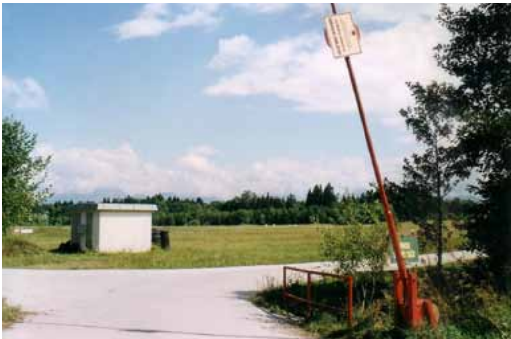
Slika 54: Transformatorska postaja VP Crngrob Vir: Fotografija dr. Draga Paplerja
