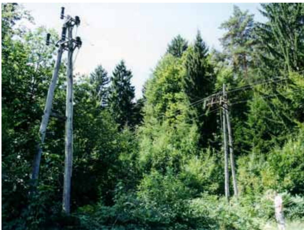
Slika 53: Daljinovod za transformatorsko postajo Vojne pošte Crngrob Vir: Fotografija dr. Draga Paplerja
