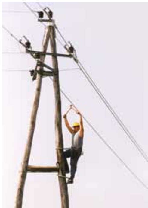
Slika 80: Prekinitev daljnovoda na odcepu za letališče Brnik, rekonstrukcija dogodka, junij 2001 Vir: Fotografija dr. Draga Paplerja
