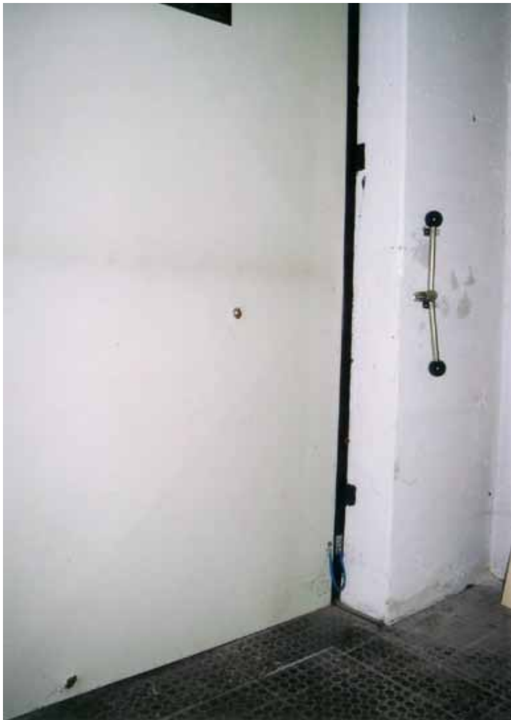
Slika 92: Poškodovana vrata stikalnega bloka v transformatorski postaji objekta H1 na karavanškem platoju Vir: Fotografija dr. Draga Paplerja
