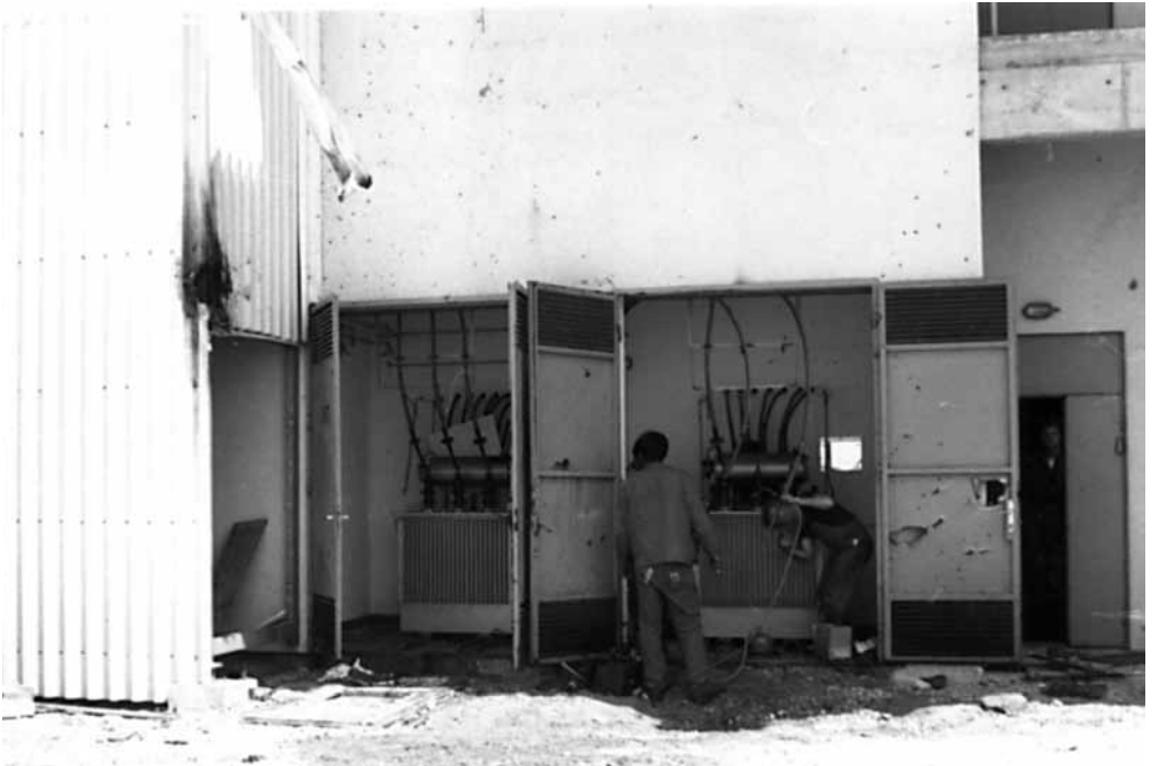
Slika 110: Poškodovana transformatorja na Krvavcu Vir: Arhiv dr. Draga Paplerja
