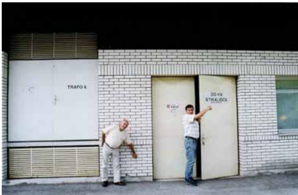
Slika 90: Poškodbe na fasadi transformatorske postaje na karavanškem platoju Vir: Fotografija dr. Draga Paplerja
