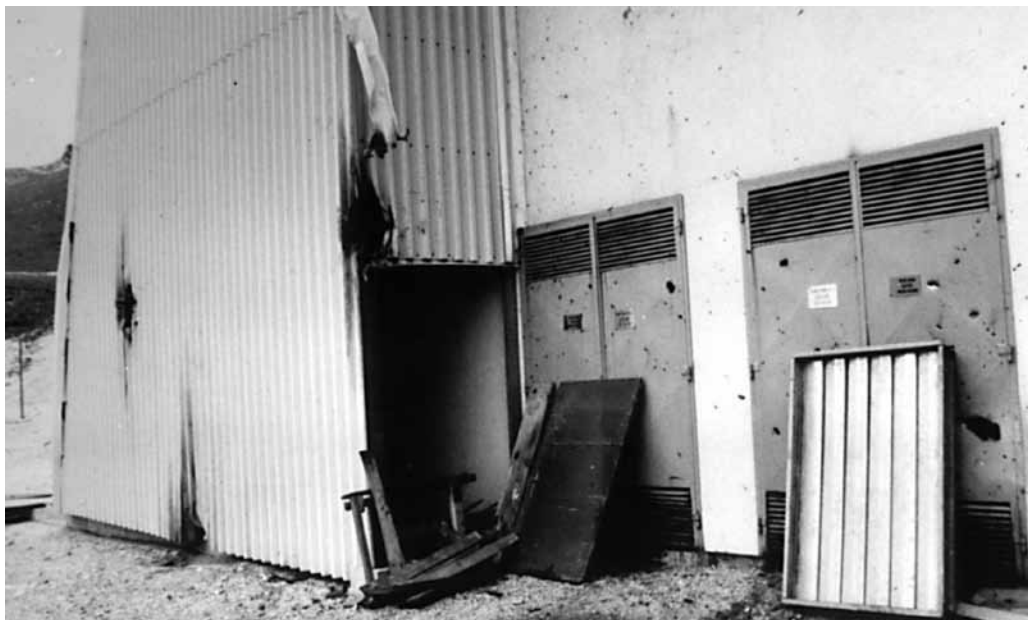
Slika 102: Razdejena transformatorska postaja RTV Krvavec, 2. julij 1991 Vir: Fototeka Gorenjskega muzeja
