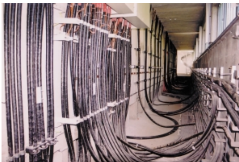
20 kV kabelski odvodi iz RTP Labore, ki potekajo do odjemalcev
