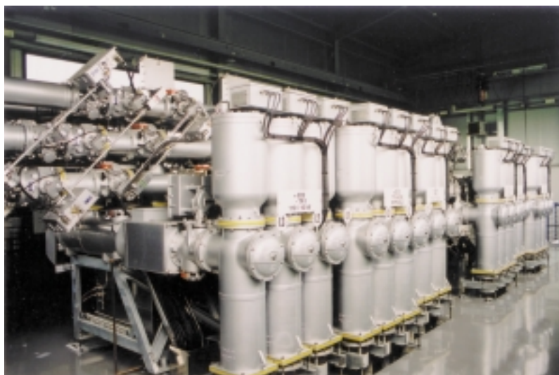
RTP Labore z modernimi stikalnimi napravami v tehnologiji SF 6
