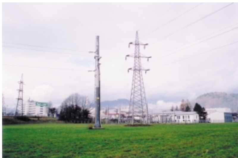
Visokonapetostni daljnovodi v Stražišču pri Kranju
