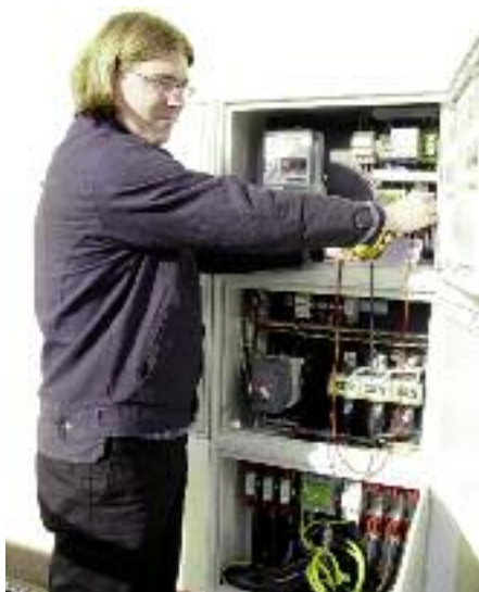
Miha Flegar opravlja zadnje preizkuse delovanja zaščite in odklopnika ločilnega mesta ter avtomatskega ponovnega vklopa elektrarne na omrežje.
