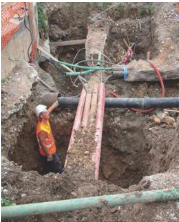
Foto: Arhiv Elektra Gorenjska
